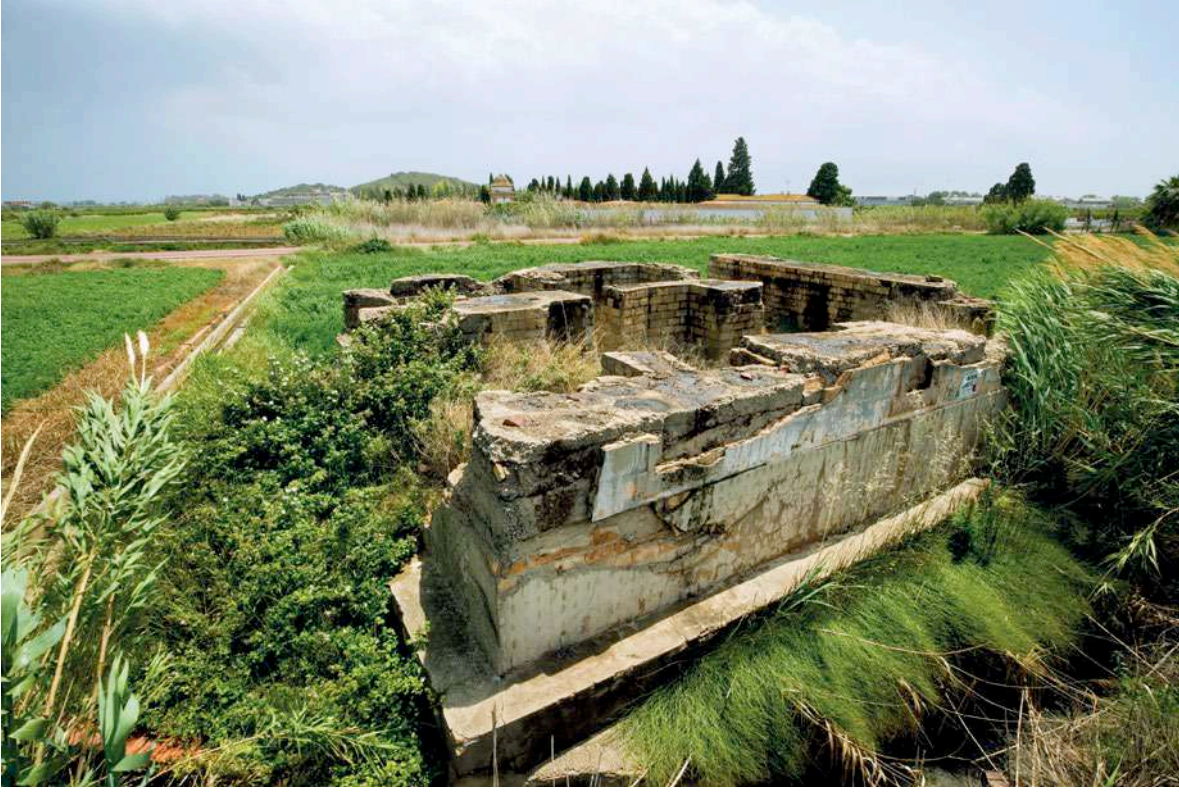
Fortí emmascarat en la carretera CV 306 a l'altura de la cartoixa d'Ara Crhisti al Puig Fortín emmascarado en la carretera CV 306 a la altura de la cartuja de Ara Crhisti en El Puig
